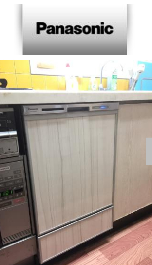
▲実際の施工後の写真 H様邸にて食器洗機の 交換工事
